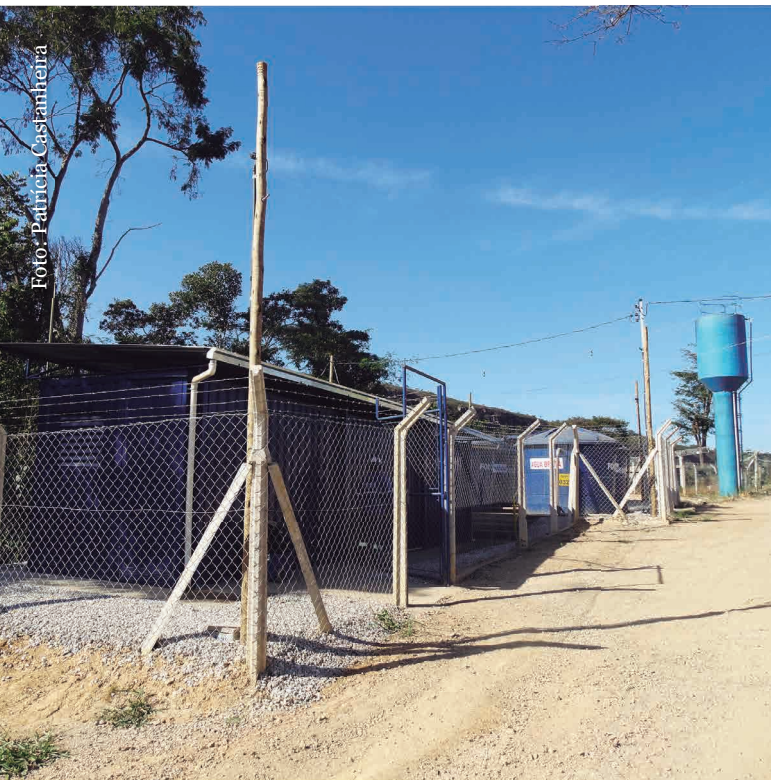
Estação de Tratamento de Água (ETA) do reassentamento Piraquara.
