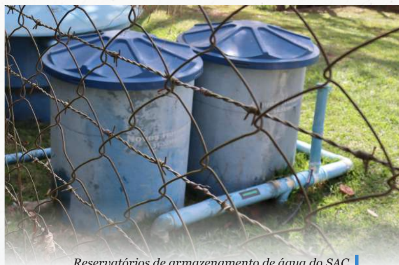
Reservatórios de armazenamento de água do SAC
